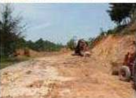
上：崩れた道路 下：現在補修中
